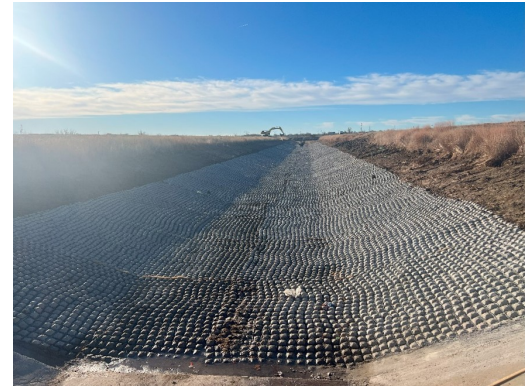
Imagen 30: El revestimiento del dique es necesario para cumplir con los requisitos de acreditación.
